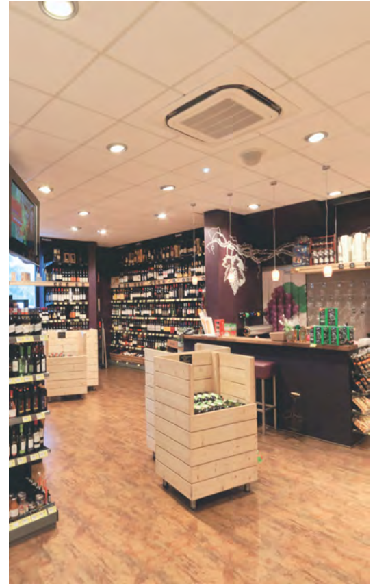
Edeka Buschkühle , Бад Валддисборн Круглопоточный кассетный блок Daikin используется для комфортного охлаждения и нагрева
